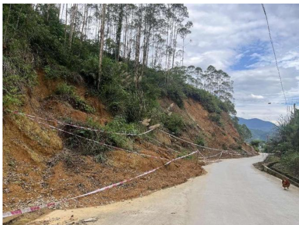
照片 11：迴龙片区现状路堑边坡崩塌（镜向 SE）
